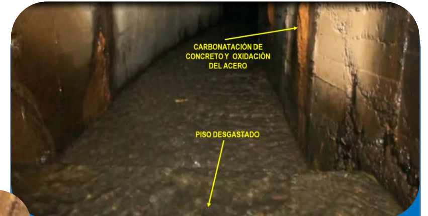
Piso desgastado y muros en concreto carbonatados
