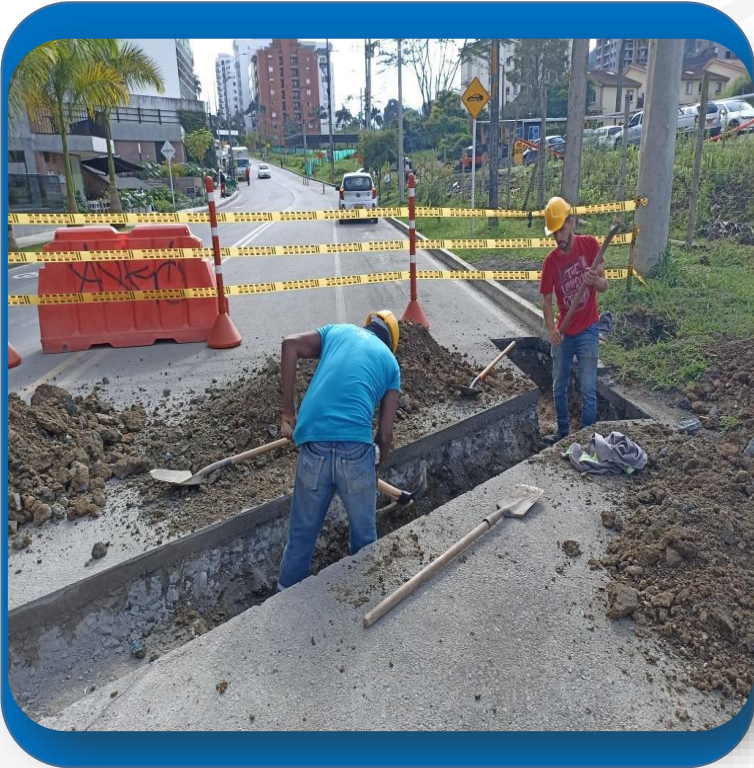
Sumidero doble reja, para el manejo de las aguas lluvias superficiales que corren por la vía.
