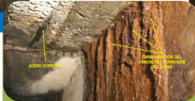
Canalización en mal estado
