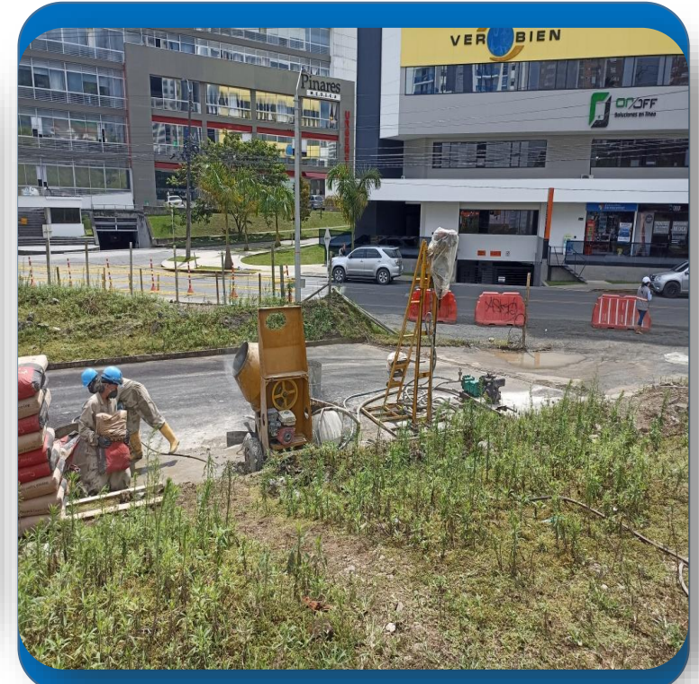
Trabajos de inyección con lechada de cemento, para mejorar condiciones geomecánicas del suelo.
