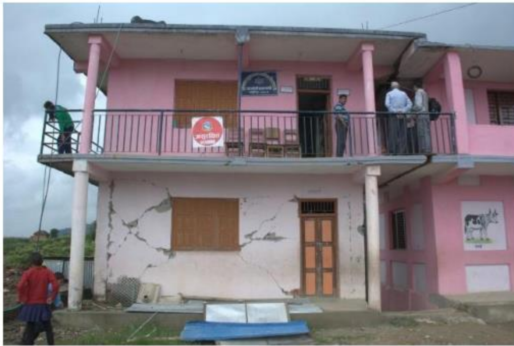
Colegio afectado por sismo
