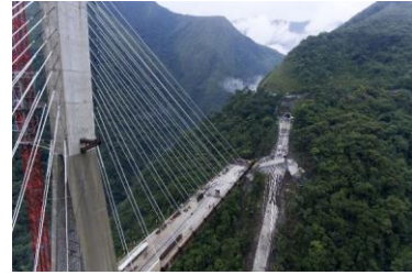
Puente Chirajara vía Villavicencio
